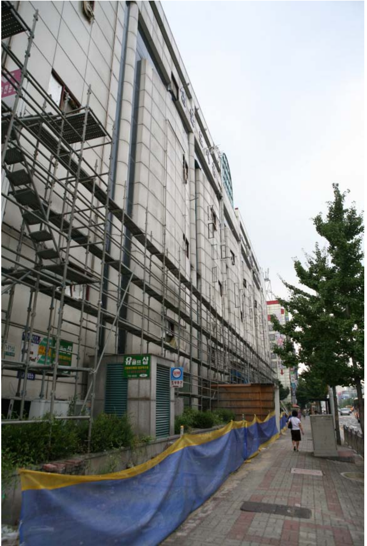
<사진, 한솔프라자 외부모습, 건물리모델링 공사가 중단된 상태로 2년째 방치되어 있다.>
